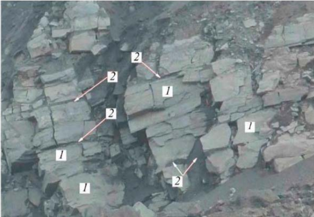
Рис. 4. Геологическая структура горного массива Кедровско-Крохалевского угольного месторождения, характеризующая зоны расположения слабых контактов: 1 – основные разностные слои массива; 2 – слабые контакты, которые могут быть представлены углистыми аргиллитами, углями, углистыми сланцами, глинистым алевролитом (мощность данных слоев обычно укладывается в интервал от 0,01 до 0,1 м)
