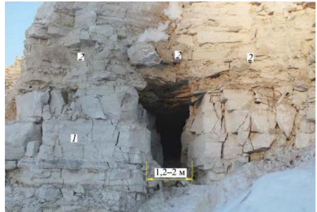
Рис. 5. Смещение нижней части технологического уступа (1) в пределах заряжаемой части скважины по кровле слабого межслоевого контакта и верхняя часть уступа (2) в пределах незаряжаемой части скважины, сохранившая свою структуру
